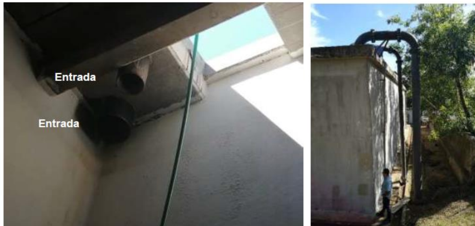
Figura 4. Tuberías de entrada del tanque de almacenamiento. Fuente: Visita técnica al proyecto, junio 2020.
