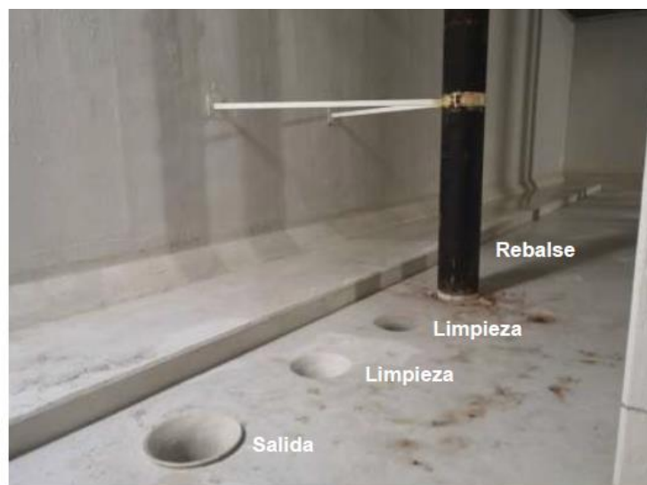
Figura 3. Tuberías de salida, limpieza y rebalse del tanque de almacenamiento. Fuente: Visita técnica al proyecto, junio 2020.
